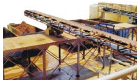
Sistema de gestión de fangos a la salida de depuradoras.
